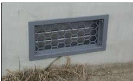
4. NON COMPLIANT VENT
